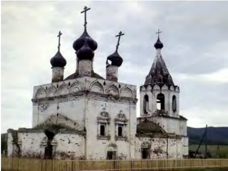
Ил. 3. Общий вид разрушенной алтарной части Нерчинской Успенской церкви (современное состояние). Снимок автора, 2012 г.
